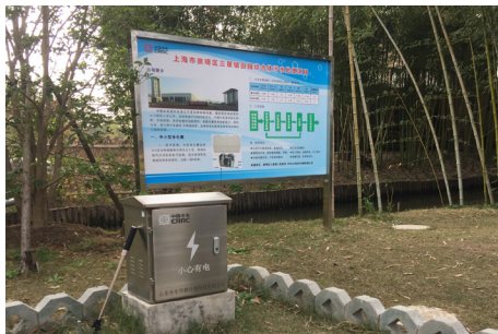
图6 乡村微型污水处理站
