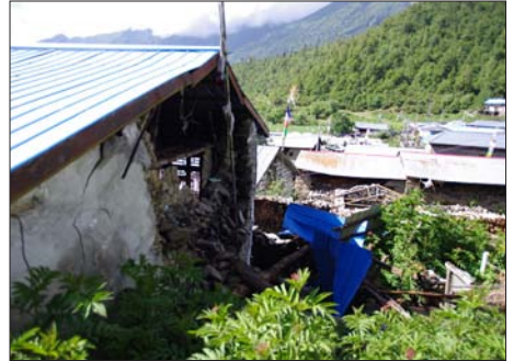
图2 地震中受损严重的村庄
